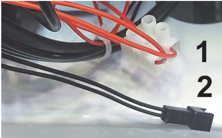
Рис. 7. Доступ к соединительным колодкам подключения комнатного термостата (1) и датчика температуры бойлера (2)
