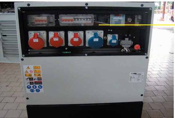
панель упр control panel
